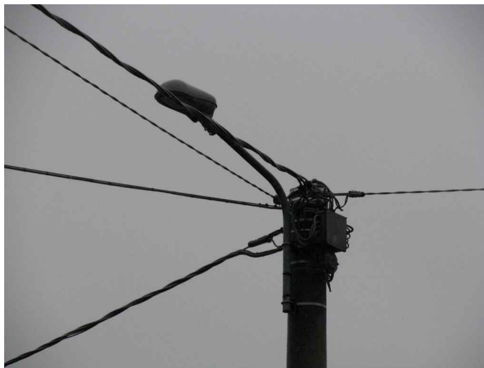
Via Mulino: giunzioni di cavi su sostegno in c.a.c.
