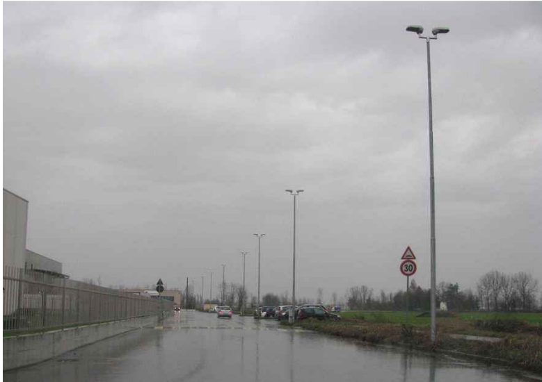
Via dell'Industria: armature stradali totalmente schermate installate su palo
