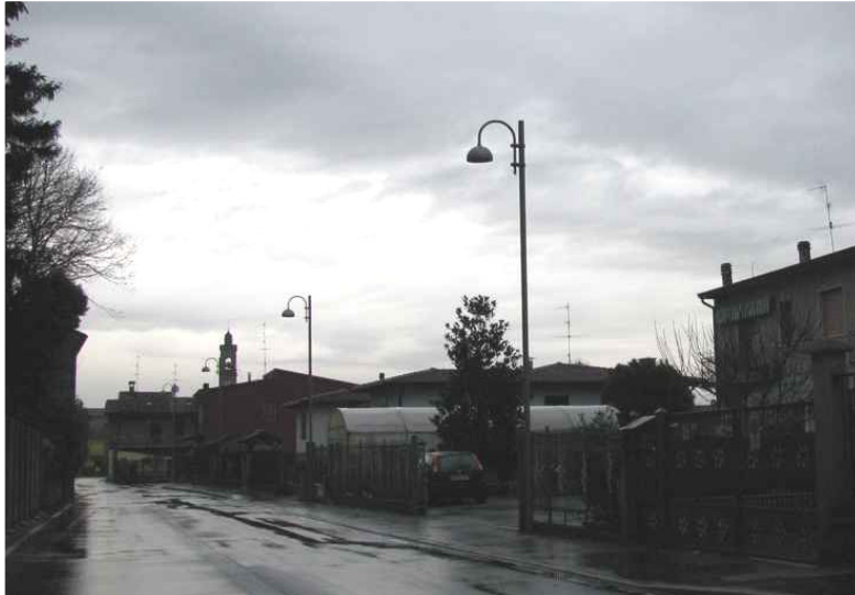
Via San Giorgio: impianto di illuminazione costituito da apparecchi decorativi dotati di vetro di chiusura piano conforme alle normative regionali.
