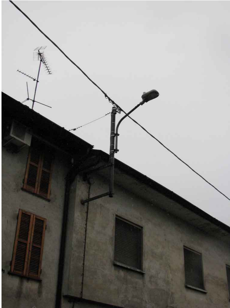
Via San Rocco: sostegno a mensola vetusto
