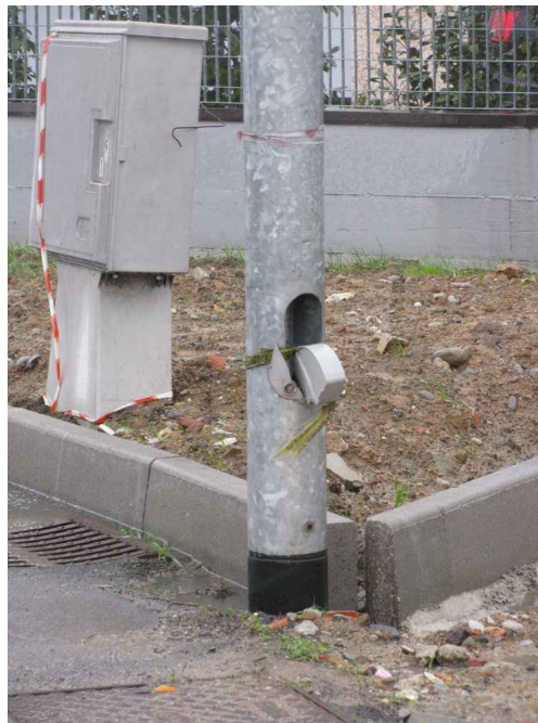
Via dell'Industria: palo danneggiato
