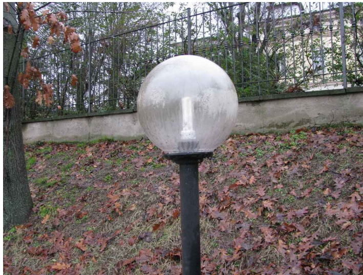
Centro Sportivo Comunale - globo diffondente equipaggiato con lampade fluorescenti non conforme alla normativa vigente.
