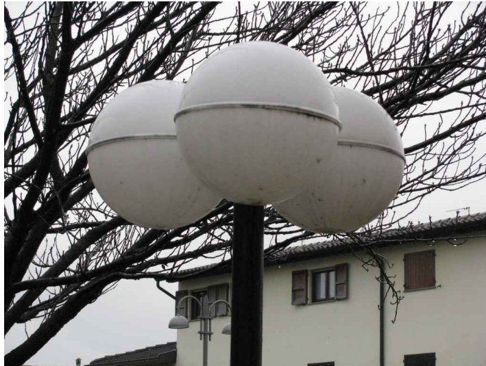
Municipio - globi diffondenti installati su palo non conformi alla L.R. 17/00 e alla L.R. 38/04
